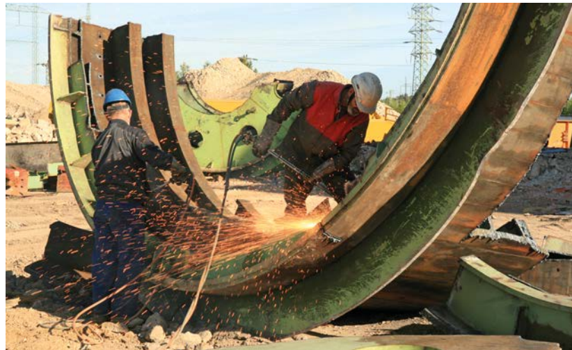
Rozpalování těžního stroje jámy č. 3 Dolu Hamr I
