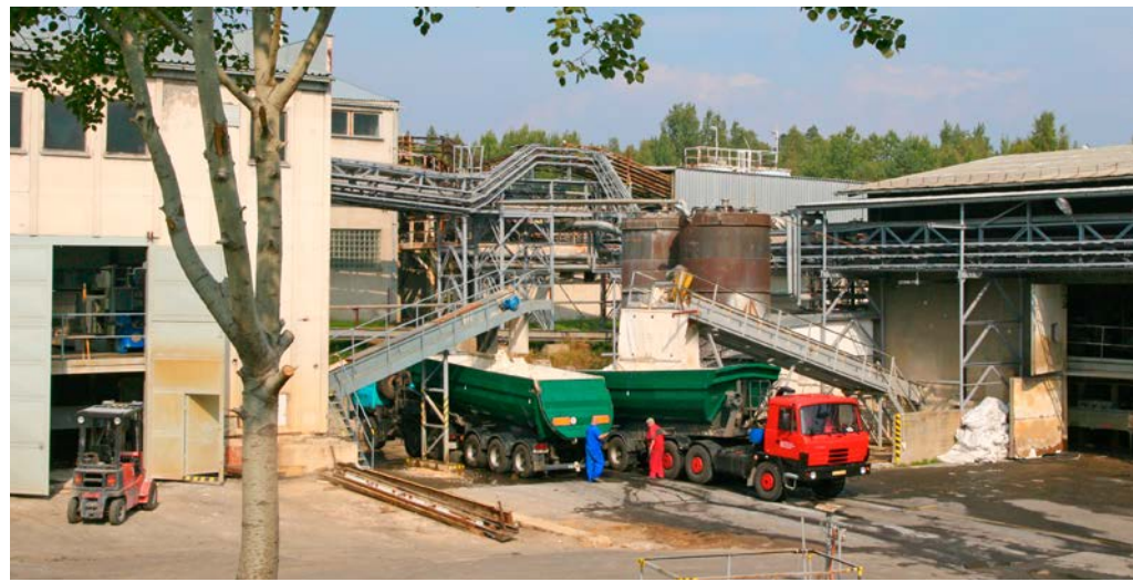
Neutralizační a dekontaminační stanice NDS 6
