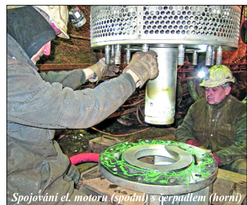
Spojování el. motoru (spodní) s čerpadlem (horní)
