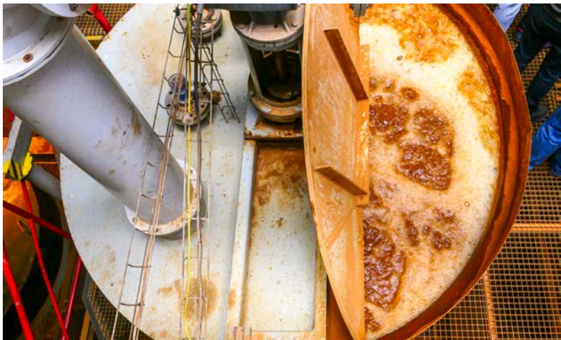
Reaktor pro oxidaci a srážení důlní vody s vápenným mlékem
