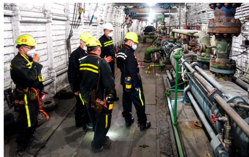
Prohlídka zařízení na čerpání důlní vody
