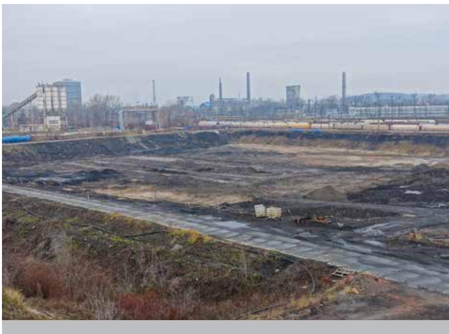
Areál lagun Ostramo v Ostravě - rok 2020 - ropné kaly jsou zpracovány, připravuje se sanace kontaminovaných zemín.
