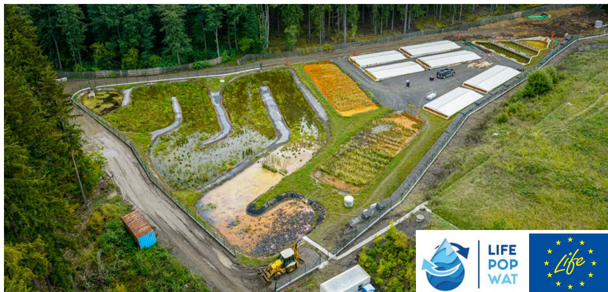
Pohled z dronu na celý systém (říjen 2022)
