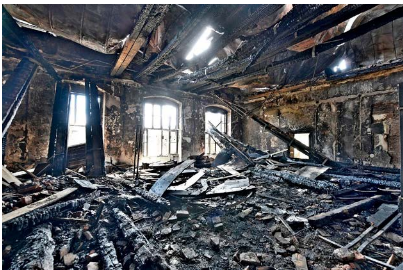
Poškození muzea v Banské Štiavnici po ničivém požáru (zdroj: SBM Banská Štiavnica)
