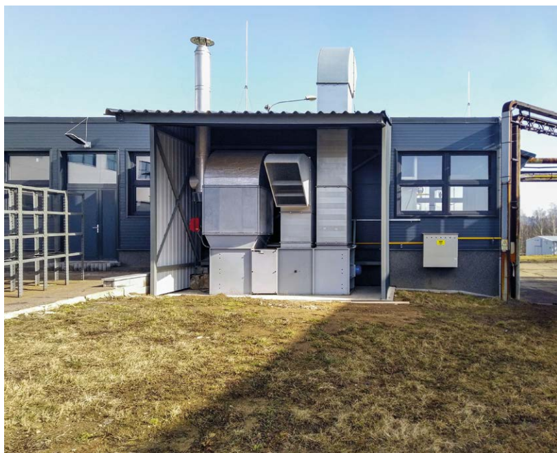
Vzduchotechnická jednotka lakovny
