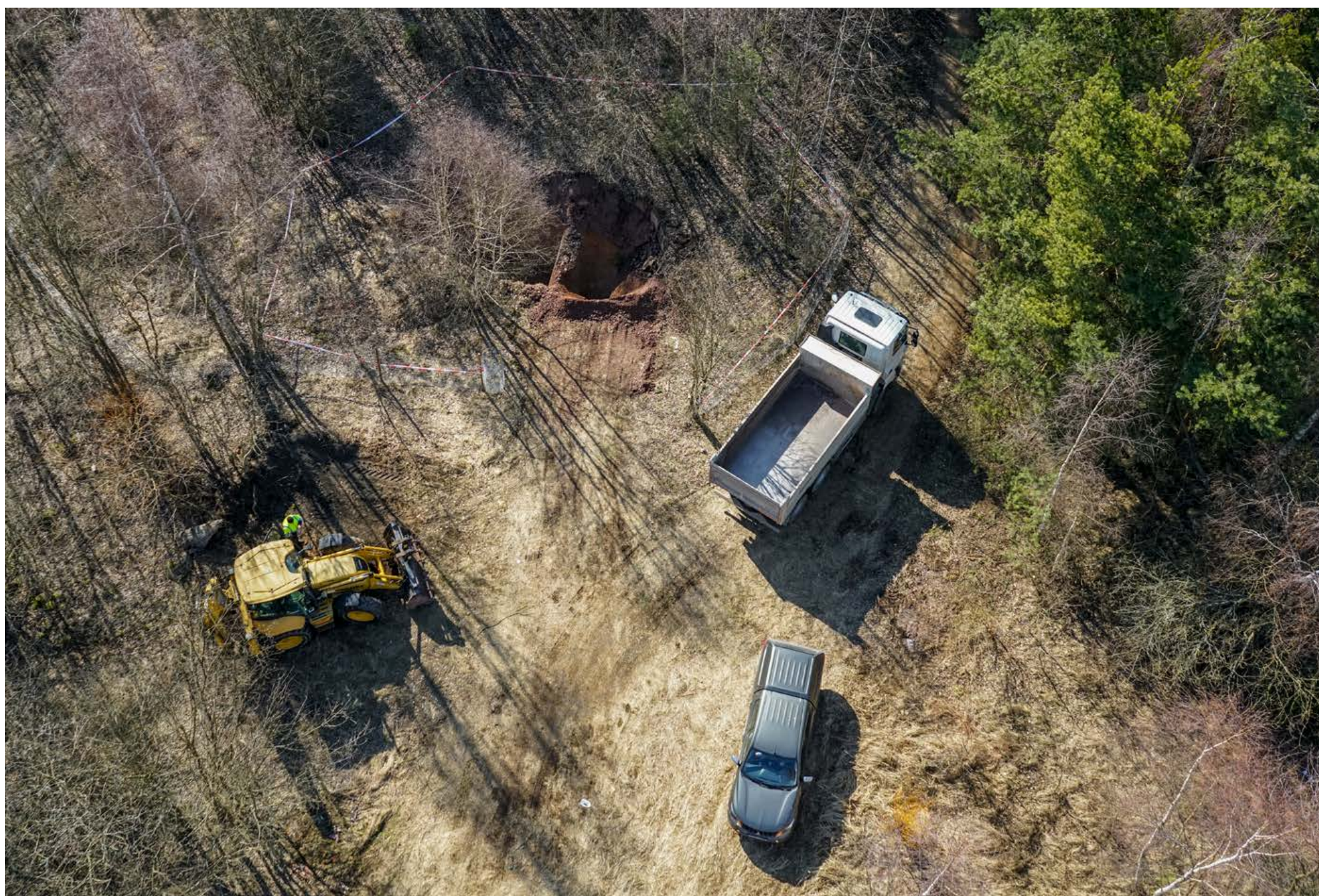
Pohled na propad z dronu
