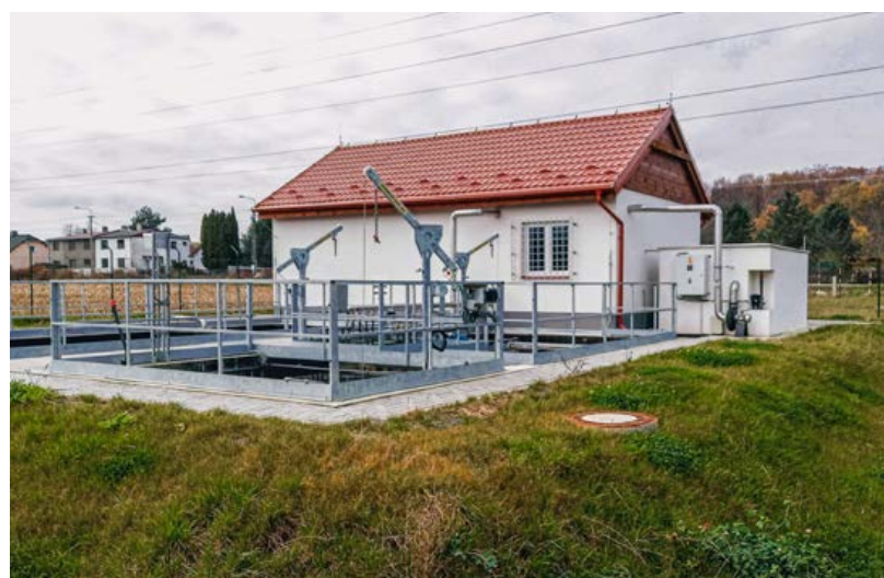
Čistírna odpadních vod pro 850 EO
