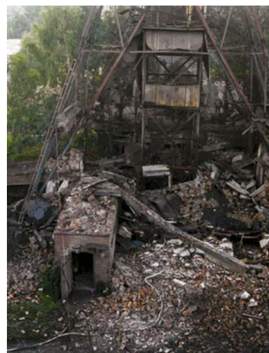
Jámová budova po výbuchu metanu
