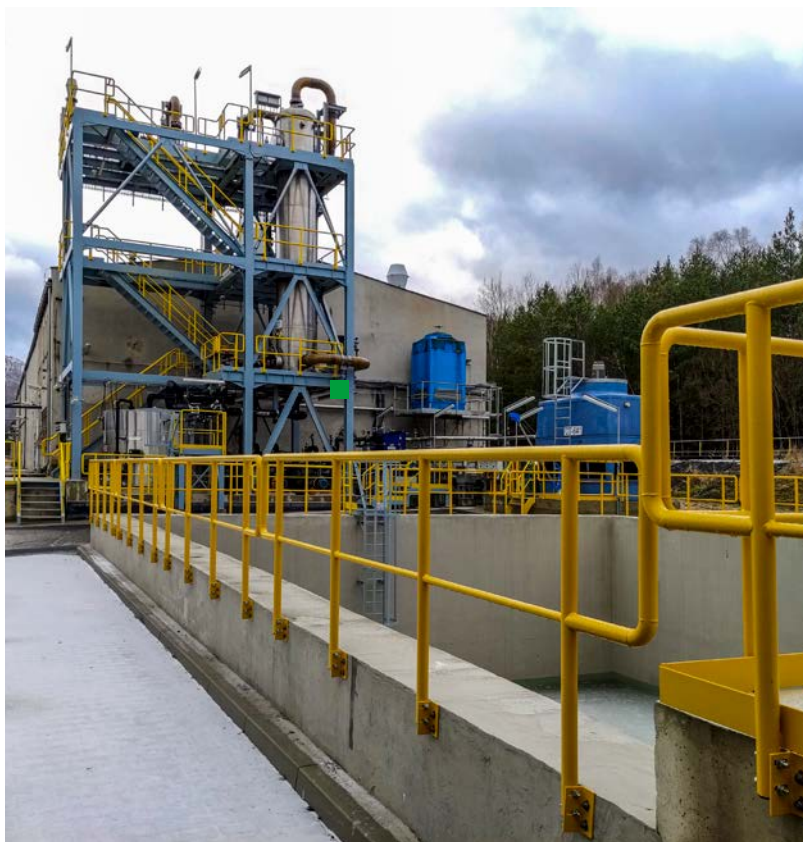
Modernizovaná jednotka systému likvidace chloru
