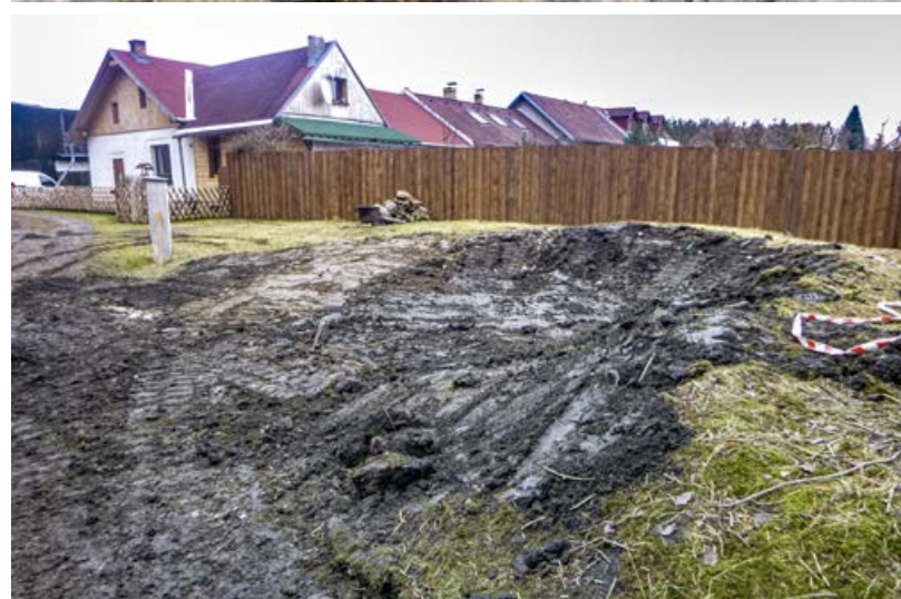
Propad v Horní Plané – stav během zabezpečování
