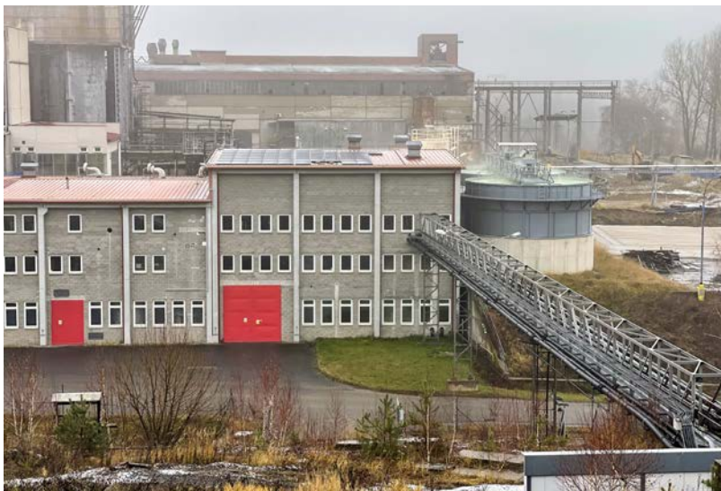
Instalované panely na střeše čistírny odkalištních vod v areálu Chemické úpravy v Dolní Rožince
