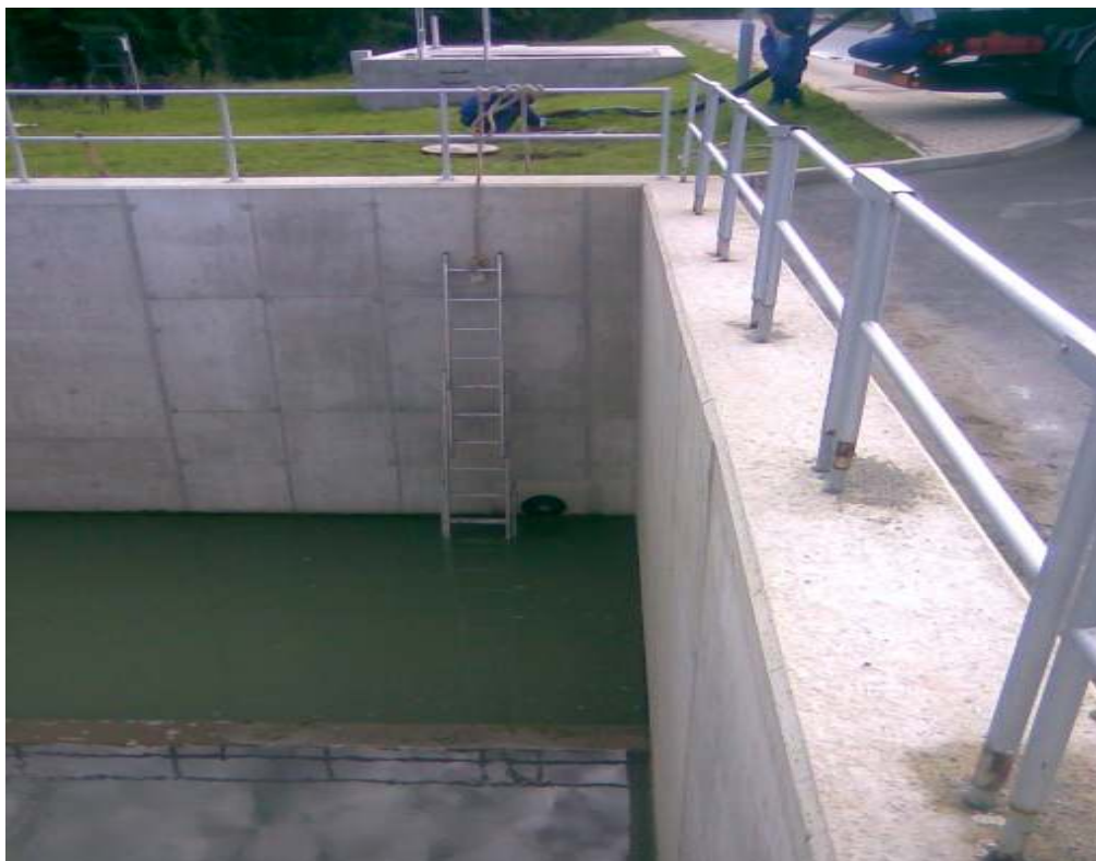
Obrázek č. 1-4: Čištění ORL U2AF3A (4,5) Techneau (součást vodního díla SED J-ML)
